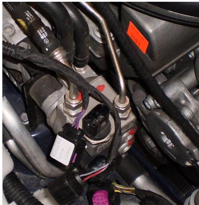
Obrázek 1 Instalovaný regulátor CNG na motoru
